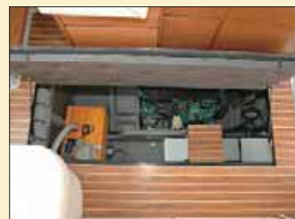
Una alargada tapa que recorre la timonera da acceso a la cámara de motores, justo bajo el salón. La instalación es holgada y contamos con un sistema de escalera por encima de las baterías.
